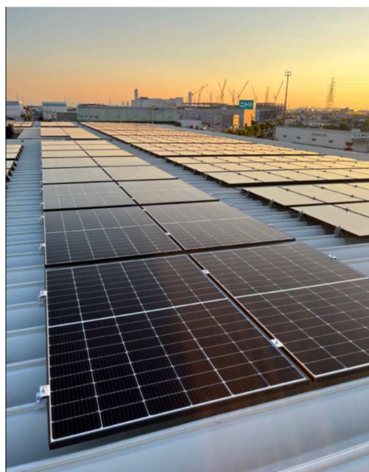
屋上太陽光発電
